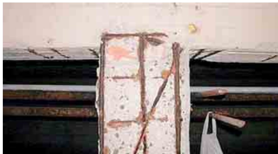
La foto mostra un particolare di un elemento portante nella struttura dell'istituto comprensivo Angelo Musco di Catania; l'evidente deterioramento del ferro e della malta ha indotto la Procura della Repubblica a promuovere il sequestro cautelativo dell'edificio al fine di evitare rischi, finché non saranno compiuti più approfonditi accertamenti e interventi conseguenti
